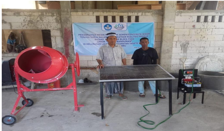
Gambar 4. Instalasi teknologi concrete mixer listrik berdaya 650 watt yang terhubung dengan pembangkit listrik tenaga surya.
