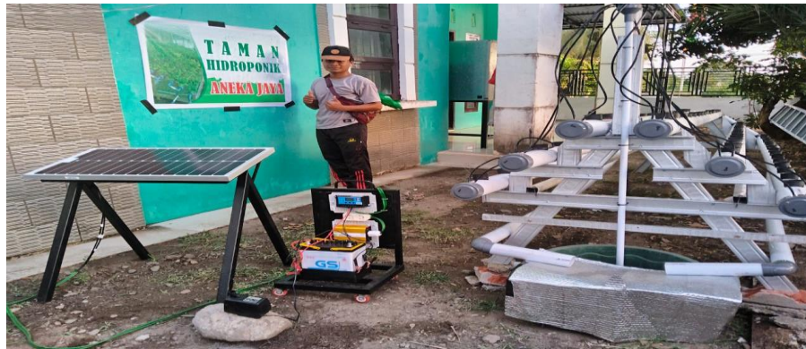
Gambar 5. Instalasi hidroponik DFT tenaga surya yang terdiri dari pipa PVC, stand baja ringan, pompa Yamano, Panel surya, inverter, dan baterai penyimpanan, siap digunakan sebagai sarana produksi selada hidroponik oleh UMKM Aneka Jaya.
