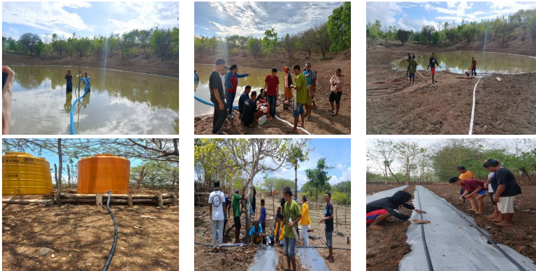
Gambar 3. Instalasi Irigasi Tetes
